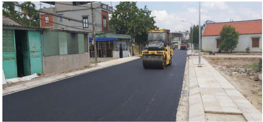
Tuyến đường giao thông nông thôn mới kiểu mẫu tại xã Đồng Thái
